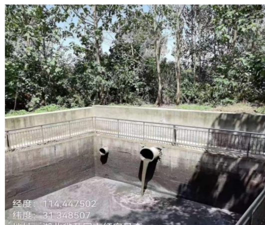
废水收集池（猪舍）
