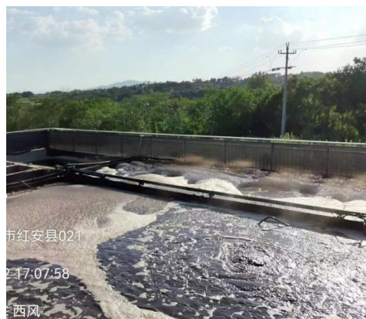
污水处理设施（调节池）
