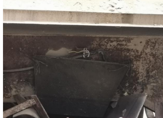
物料输送转接处喷淋装置
