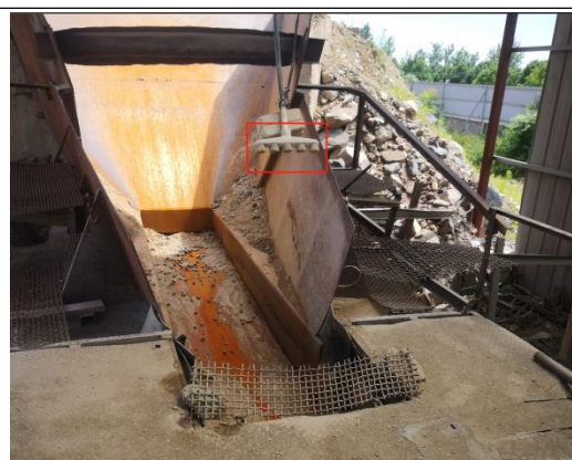
投料口喷淋装置
