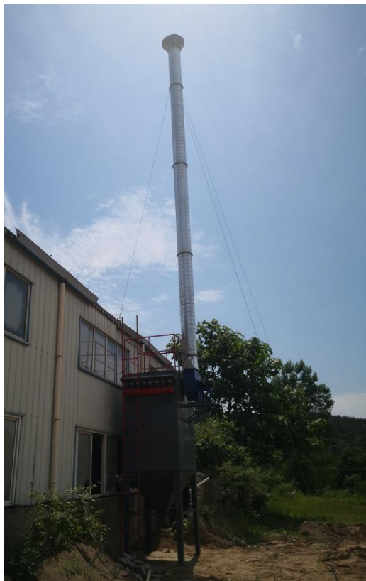
布袋除尘器及排气筒
